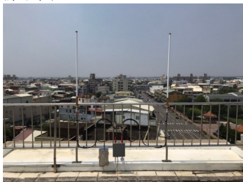
圖4：中華電信西港營運處頂樓架設LoRa GTS
